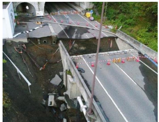
図 8 令和元年 10 月の被災状況
