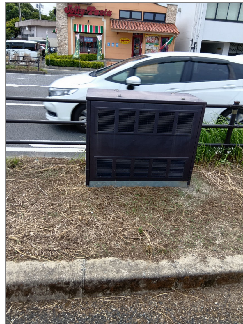
▲地上機器の状況
