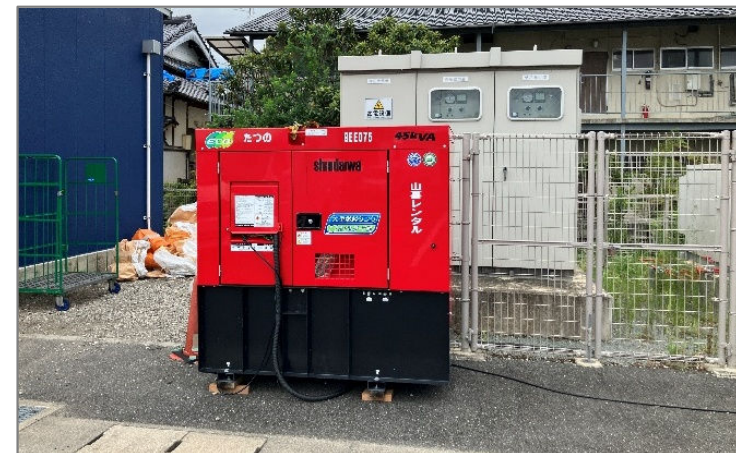
▲ランドリー稼働用の水と電源。電源はレンタル発電機
