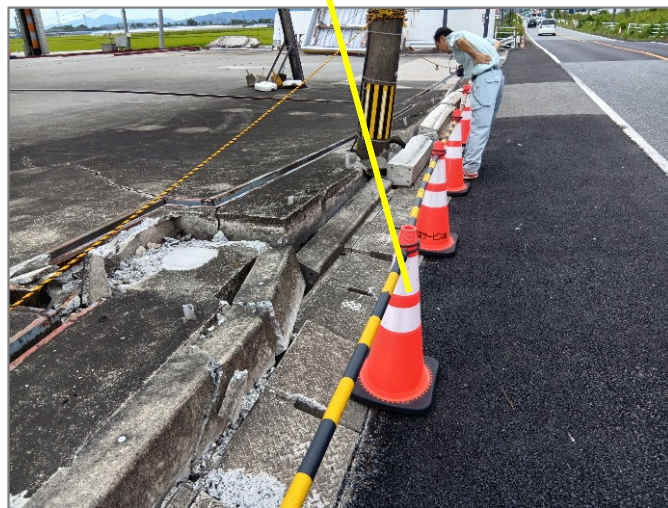
▲傾斜した電柱①
