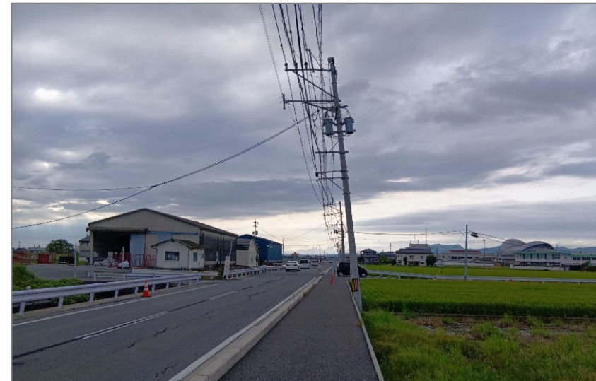
▲傾斜した電柱③
