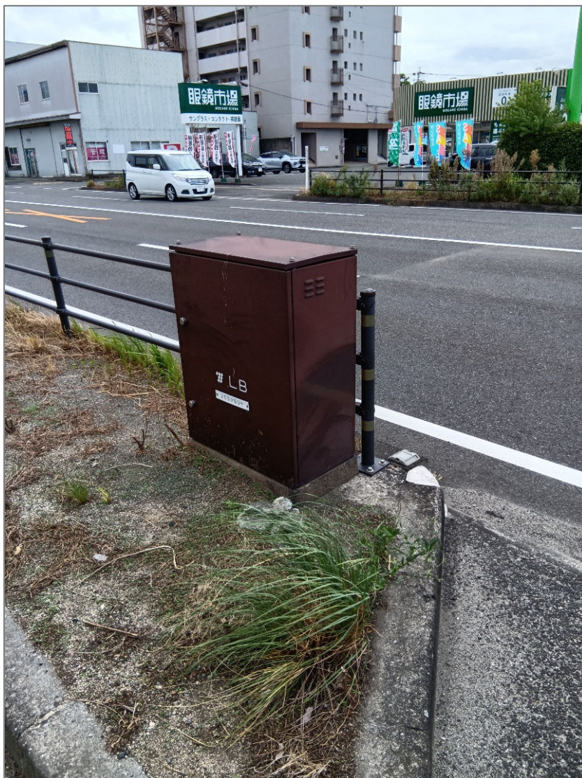
▲地上機器の状況
