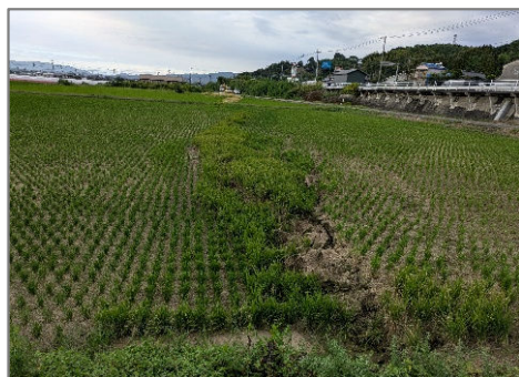
▲地表地震断層(道の駅竜北付近)
