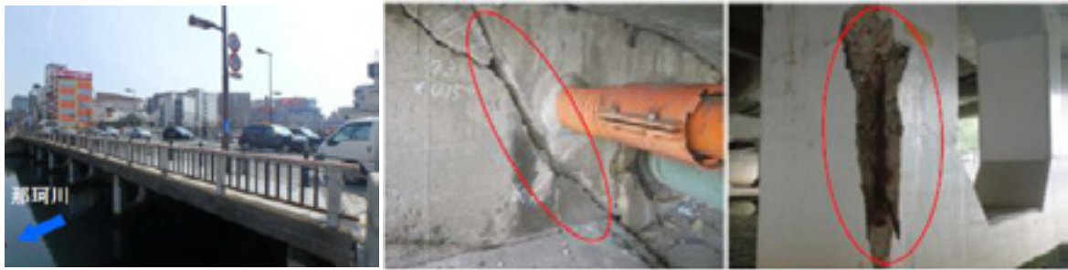
写真-2 春吉橋の老朽化の状況
