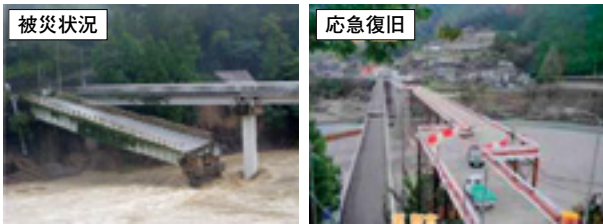
写真-3 折立橋の被災と迂回路の設置
