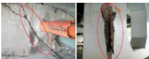
写真-1 春吉橋の老朽化の状況
