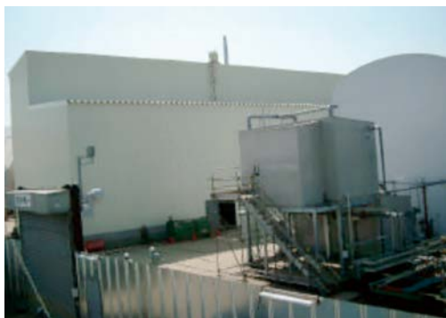
写真-4 無害化処理施設
