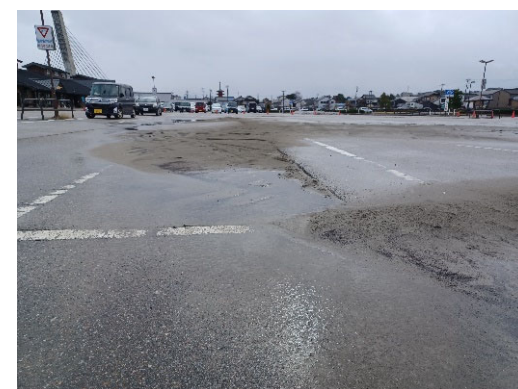
駐車場の被害(氷見)
