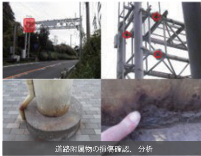
道路附属物の損傷確認、分析
